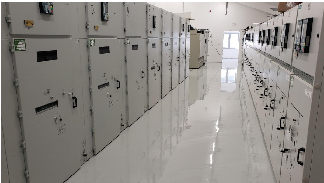
Slika 5..Primjer razvodnog postrojenja u trafostanici 35/10kV
