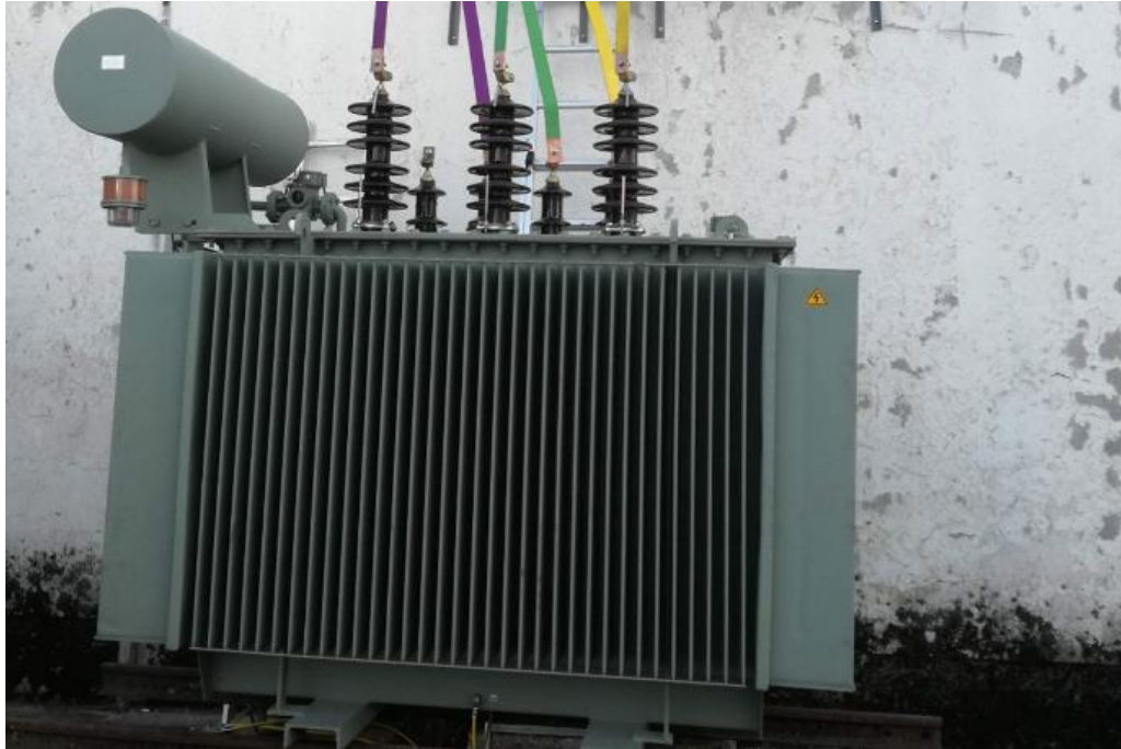
Slika 4..Primjer jednog transformatora 35/10 kV
